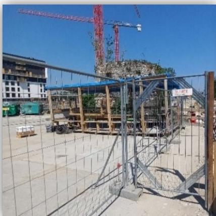
Dodatkowe bramki kontroli dostępu Kraków Puskarska C/D
