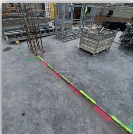
Oznakowanie sprayem progów na stropie Poznań Apator I
