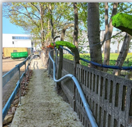
Oznakowanie sprayem słupów ogrodzenia wchodzących w światło przejścia w drodze komunikacyjnej Wrocław Jaworska R4R
