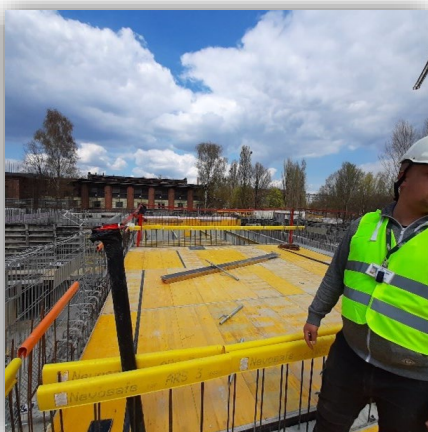
System asekuracji / słupki linii życia Strumin Łódź Fuzja F
