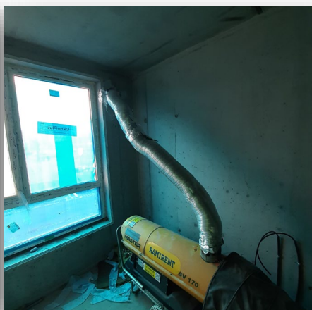
Odprowadzenie spalin z nagrzewnicy Lobos
