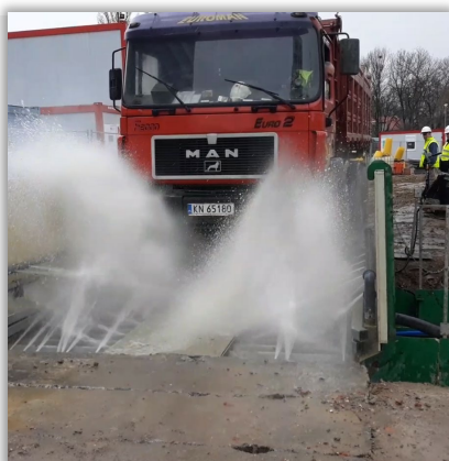
Myjka dla samochodów budowy Brain Park
