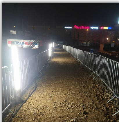
Oświetlenie ciągów komunikacyjnych
