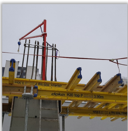
Gniazda pionowe do podczepiania poziomej liny asekuracyjnej Stacja Wola II
