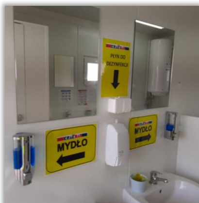
Toalety i punkt do dezynfekcji Bonarka Living
