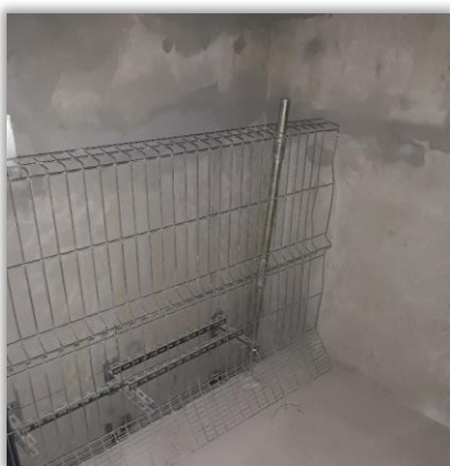
Zabezpieczenie szachtów REACT
